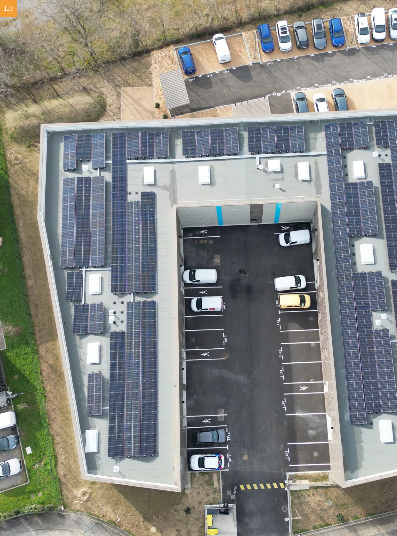
VUE AÉRIENNE DE LA CENTRALE PHOTOVOLTAÏQUE DU VILLAGE D'ENTREPRISES - GIVORS (69)
